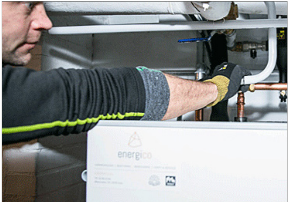
Varmepumper er fortsatt «hot» illustrasjonsbilde: Markus Loostrand i Energico monterer væske-vann varmepumpe. Foto: NOVAP
