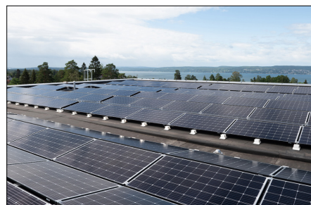
Solcelleanlegget på taket av skolen.
