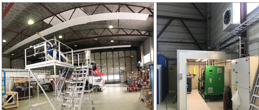
Figur 11. Helikopterhangar med strålepaneler i taket (til venstre), og maskinrom for CO 2 -varmepumpe og elektrokjel (til høyre).
